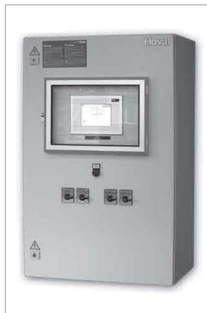
Slika L2: DigiMaster ugrađen u vrata zonske komandne table (u ovom slučaju sa okvirom za DigiMaster)
